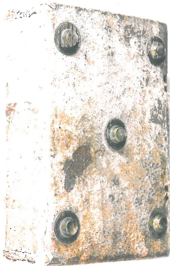
après: la déchirure du mors supérieur a été stabilisée
